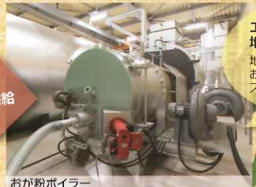
おが粉ボイラー
